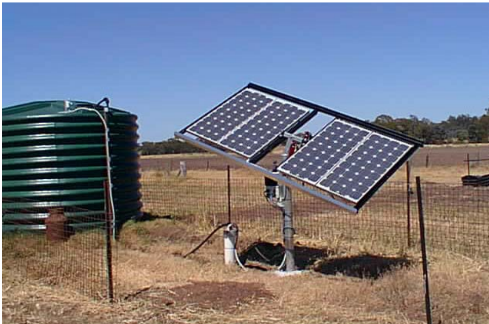
soporte para la bomba solar fotovoltaica
